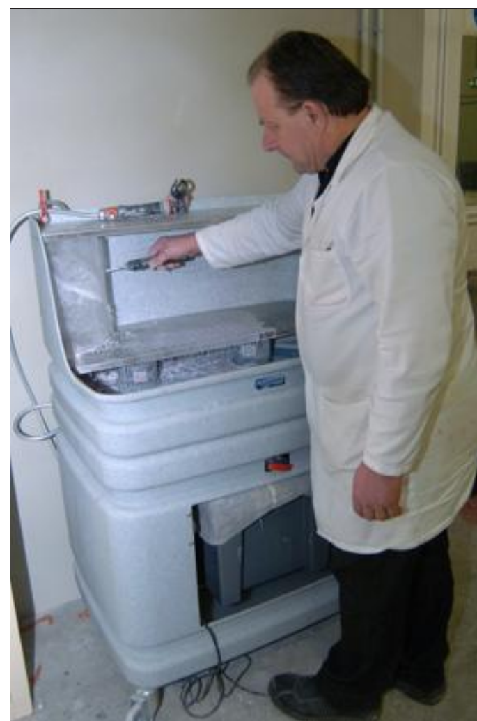
L'atelier peinture est équipé de cinq stations de nettoyage de rouleaux et de pinceaux. Photos RL
